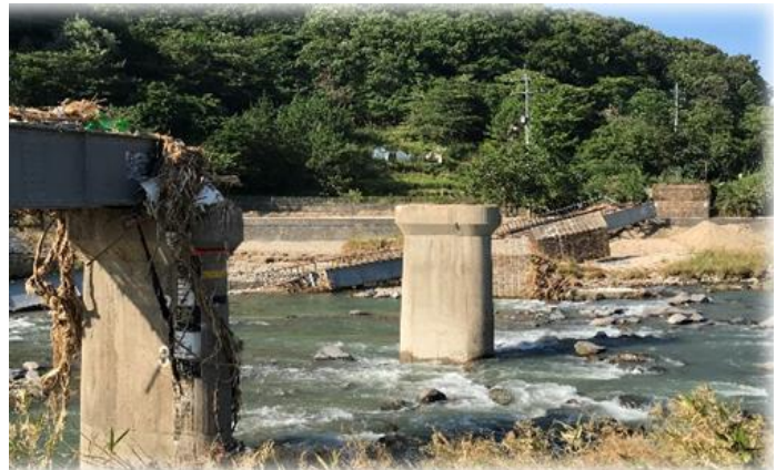
JR芸備線の狩留家～白木山間 寸断された第1三條川橋梁
