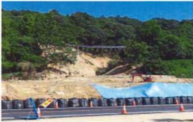
広島呉道路が崩れガードレールだけに。その下の呉線・水尻駅付近は土砂で埋没
