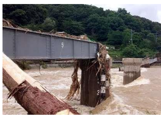
J R 芸備線・狩留ー白木間で流出し
