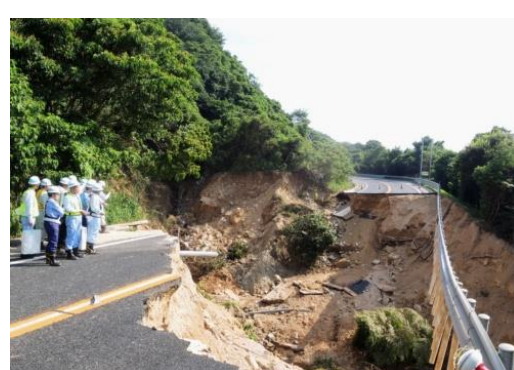
写真左手からの土石流により道路が崩壊した広島呉道路
